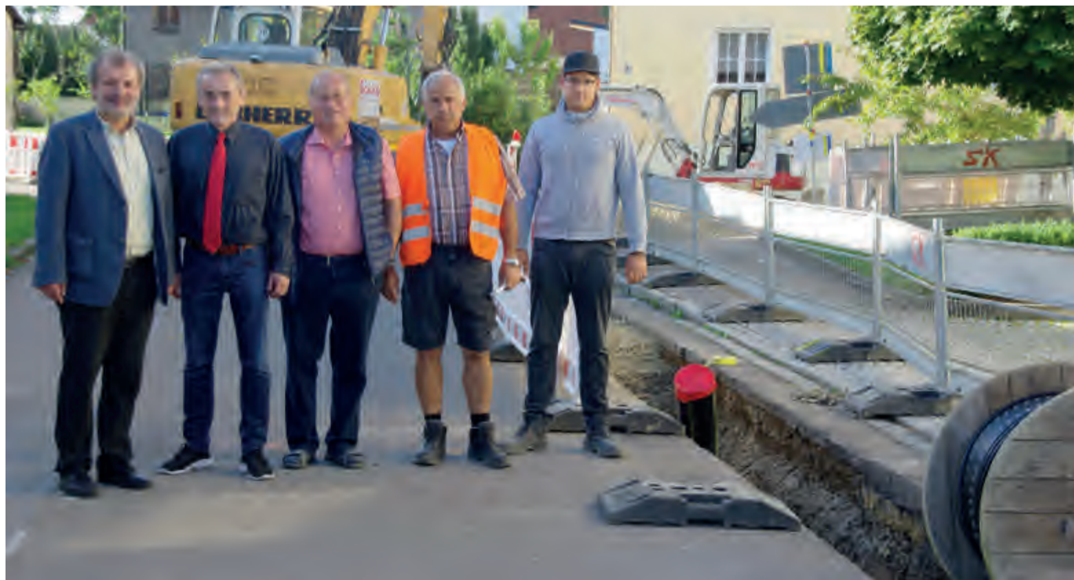
▲ Projektbeteiligte und Baufirma (v.l.): 1. Bürgermeister Andreas Birzer, BEG-Vorstand Dr. Bernd Weber, 3. Bürgermeister Werner Schmelz, Karl Schad und Florian Schad (Tiefbau)
